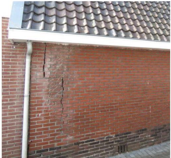
Foto 5.7: Scheuren in de linker zijgevel ter plaatse van de aansluiting aanbouw.
