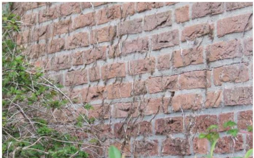
Foto 5.6: Scheur in buitengevel die niet verticaal loopt (scheur
