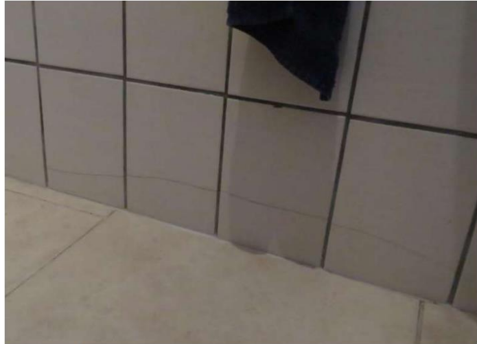
Foto 5.3: Scheur in tegelwerk op wand toilet (scheur 7).
